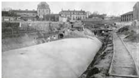
▲ 1910. Construction de la ligne A du Nord-Sud - 1 er lot - rue Desnouettes, raccordement avec le dépôt et les stations, la voûte du souterrain est complètement terminée et les 2 égouts latéraux sont en construction à proximité de l'actuelle rue Auguste Chabrières.
